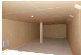
2階全体を屋根裏に設置するエアコン1台で空調
